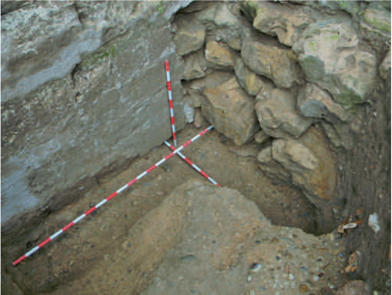
Imagen de las cimentaciones de la torre y del cuerpo de la iglesia localizadas en el Sondeo 2. En ella se observa cómo el paramento de buena calidad de la torre es alterado por una cimentación irregular que pertenece a la construcción gótica
