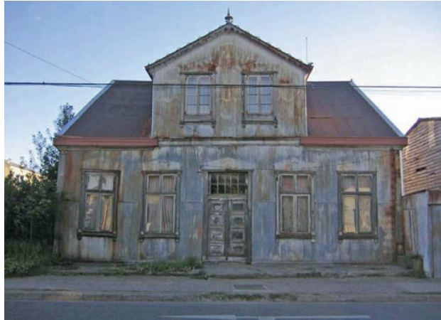
Figura N. 10 Vivienda pre intervención. Foto: Víctor Nadal
