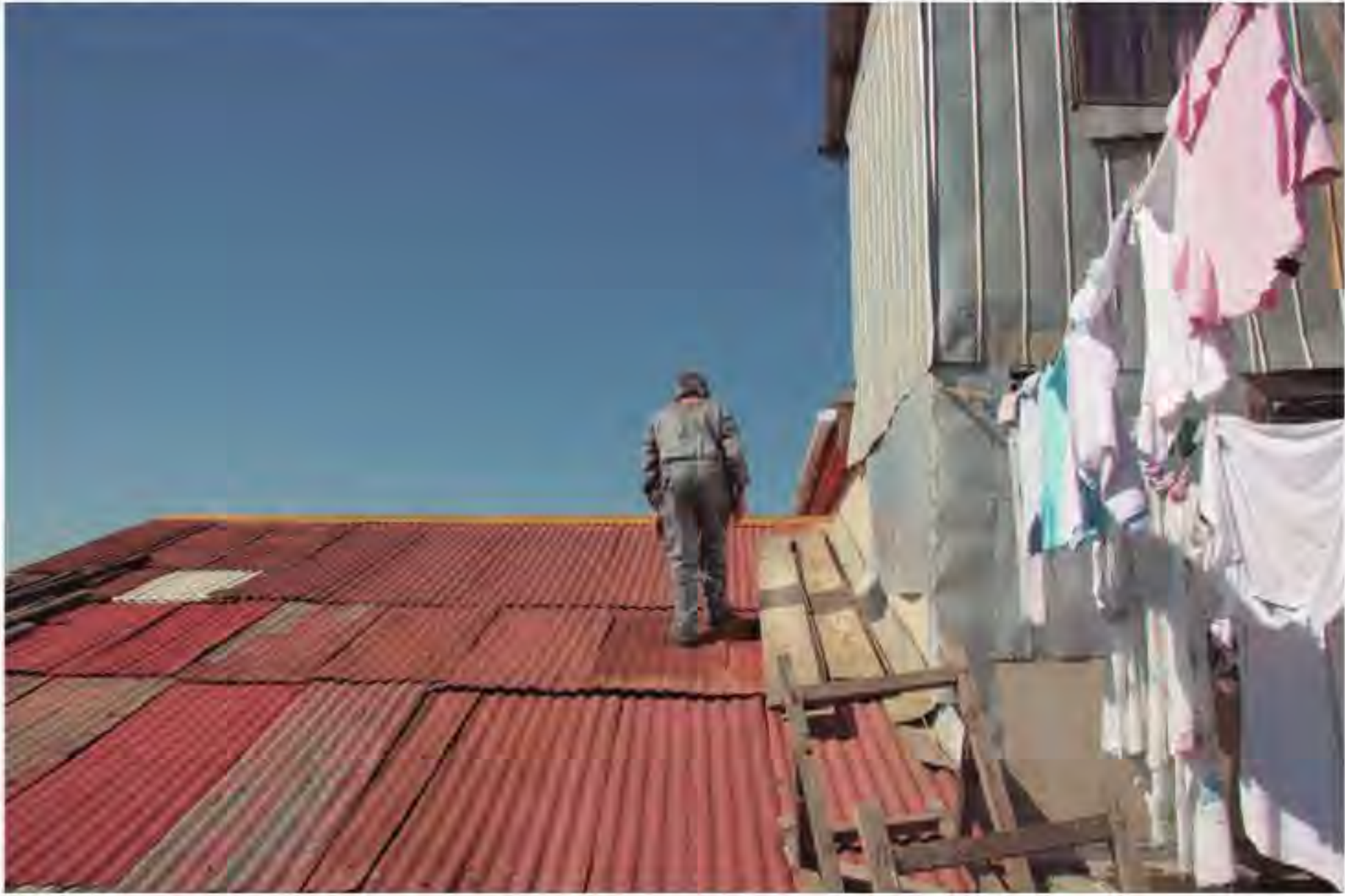
Figura 2 Propietario de vivienda de Cerro Cordillera transitando sobre su techumbre. En muchas viviendas, como este caso, los usos de los distintos elementos arquitectónicos trascienden a los propuestos por las definiciones arquitectónicas clásicas. Fotografía por Pau Faus.
