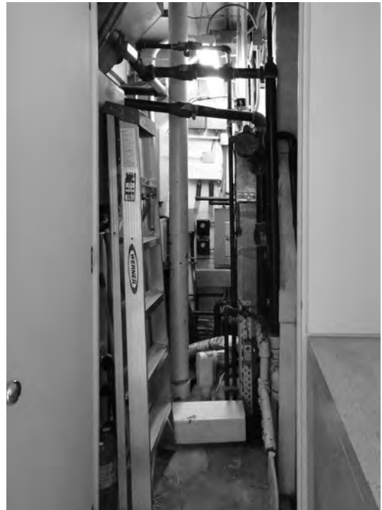
Figura 7. Acceso desde el baño social al cuarto técnico, ubicado en el interior del núcleo de servicios. Fotografía: los autores, 2013
