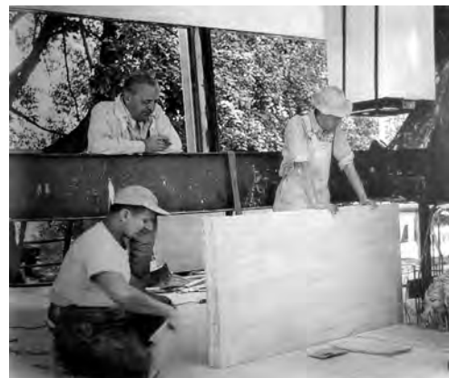
Figura 16. Proceso constructivo. Mies apoyado en la viga que soporta la estructura de la chimenea
