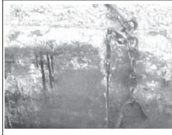
Fotografía 10. Aspecto del muelle después del tratamiento (producto MF 2).
