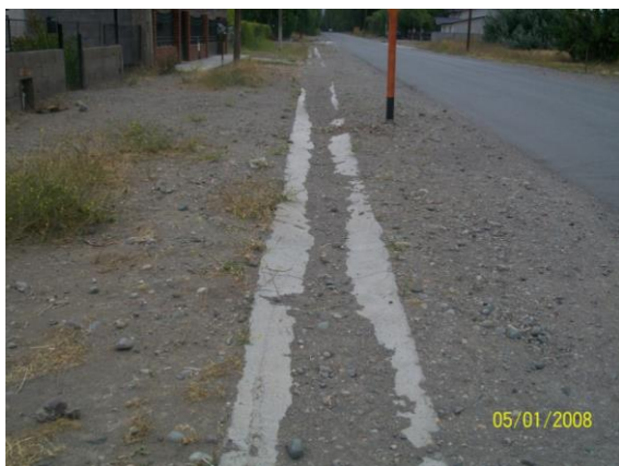
Fig. 14. Cordón cuneta sin mantenimiento. Obsérvese además el desnivel existente entre la posición del cordón y el asfalto, situación que favorece la concentración de la escorrentía en la calzada. Foto: Viegas, M.
