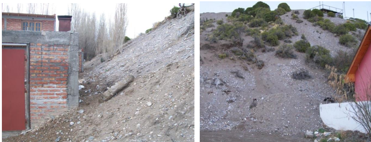
Fig. 13. Ladera de la Loma del Mirador donde se aprecia su escasa cobertura vegetal, el material suelto que la cubre y se desplaza en la pendiente, las construcciones en su cima (mirador) y base y el paredón construido por los vecinos como contención. Foto: Navarro, M.
