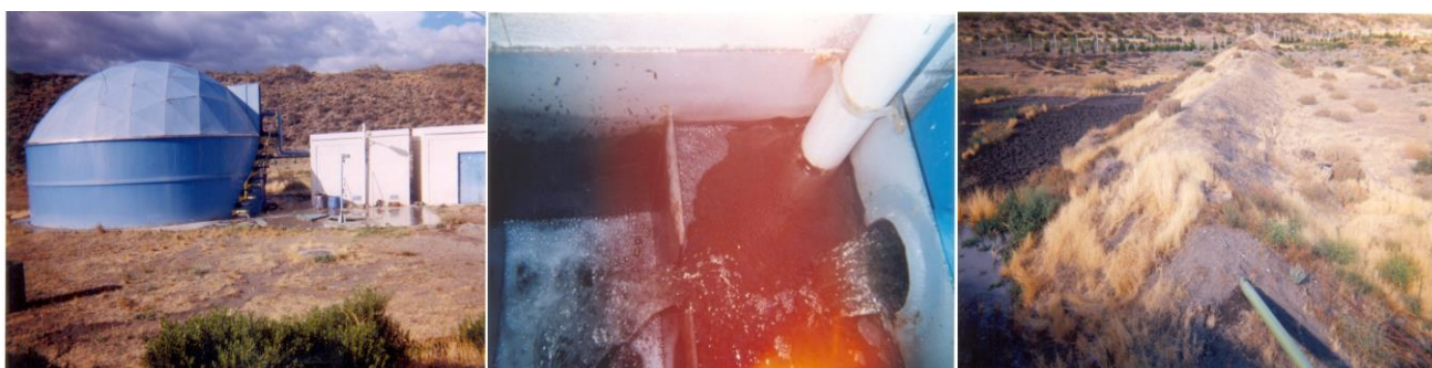
Fig. 18. Vista de la planta de tratamiento (izq.), los líquidos cloacales tratados (centro) y la playa de secado a cielo abierto (der). Foto: Valdés, A.
