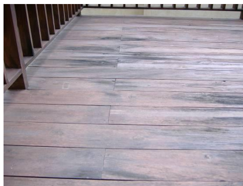
“Deck” con problemas de manchado y pudrición incipiente, producto de una inadecuada protección de la madera con que fue fabricado.
