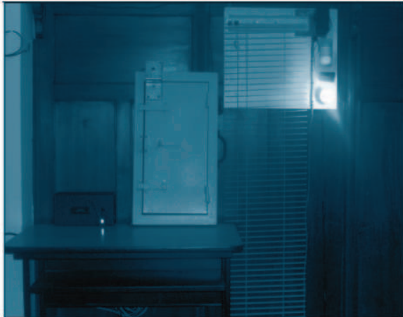
Figura 3: Montaje de prototipo de actuadores domóticos.
