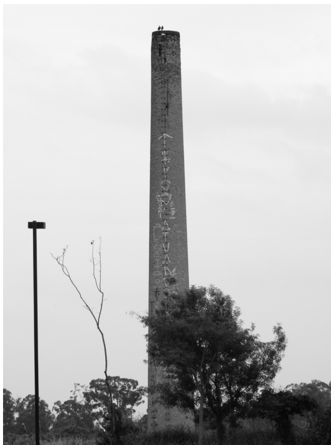
Figura 3 – Chaminé bastante degradada
