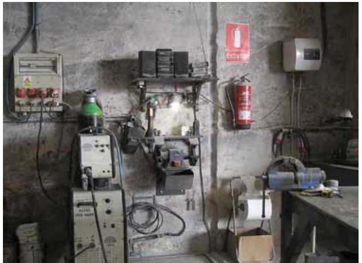
Extintor en taller de mantenimiento
