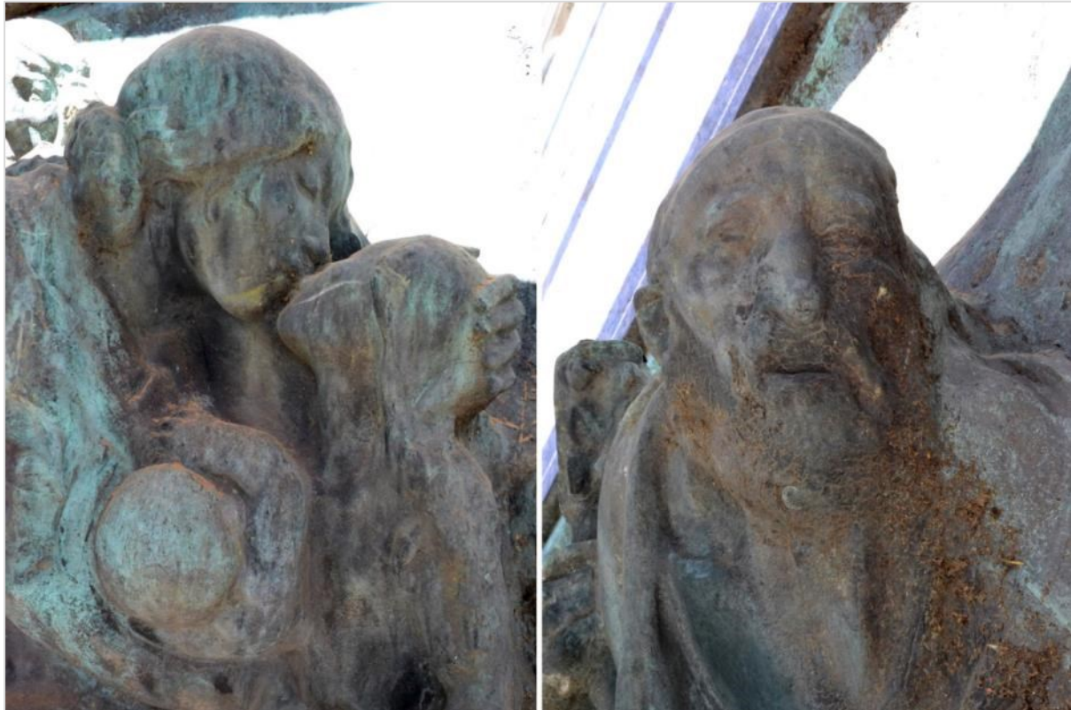
Figura 2. Depósitos superficiales y corrosiones en escenas del relieve perimetral. ©Jimena Schroeder - Claudia Frigerio.
