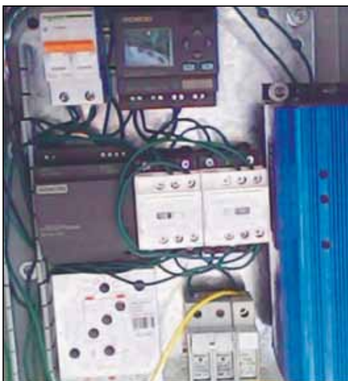
c) Vista del tablero de control
