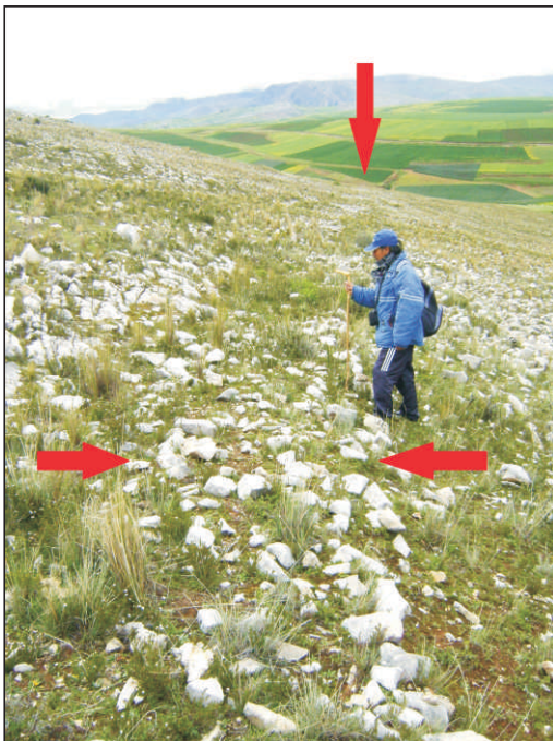
Foto 1: Estado actual del camino A cerca del vértice 06. La flecha vertical señala la ubicación del vértice 01. Las flechas horizontales indican los bordes del camino.
