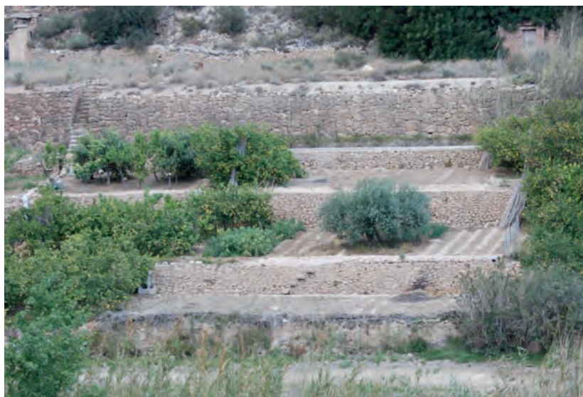
Fig.6. Terrazas de cultivo en ladera construidas con muros de piedra seca. Margen izquierda del río, próximo a la noria de La Ribera (Ojós)
