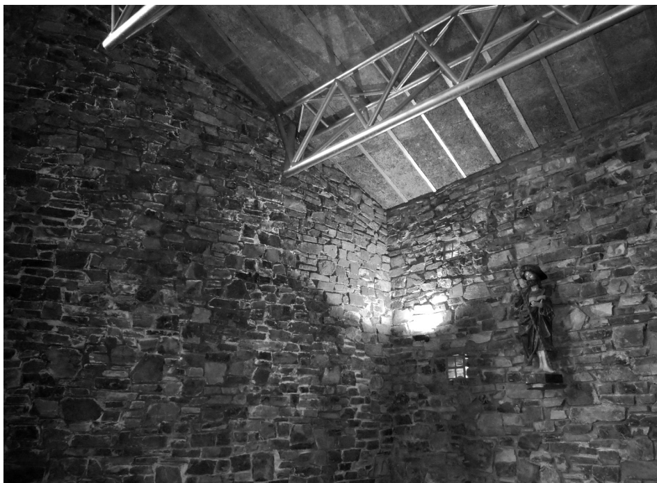
Fig. 12. Detalle de eflorescencias en el interior (coincidentes con los canales que vierten por el muro).
