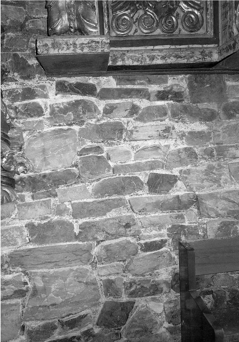
Fig. 15. Detalle de eflorescencias, en el interior junto al sagrario.
