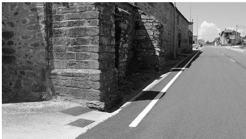
Contrafuertes de la “sacristía antigua”. El canalón del agua se adentra varios metros en el suelo, a la altura del último contrafuerte. Ello significa que hace unos años, cuando se hizo, se destruyó una cantidad de información arqueológica impresionante. Este trato tan injusto a un Santuario tan importante debe de ser paralizado de inmediato. Foto: Julio Badenes.
