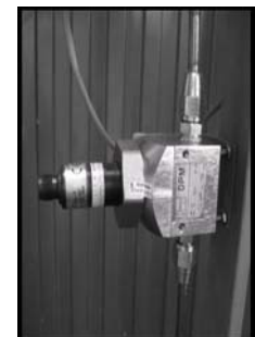
Figura 5. Sensor de caudal instalado
