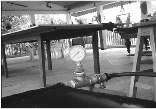
Figura 2. Fotografía ensayo de presión, manómetro ubicado en la entrada del colector, fuente de presión red de acueducto
