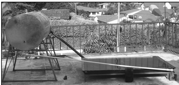
Figura 1. Fotografía panorámica del sistema de calentamiento
