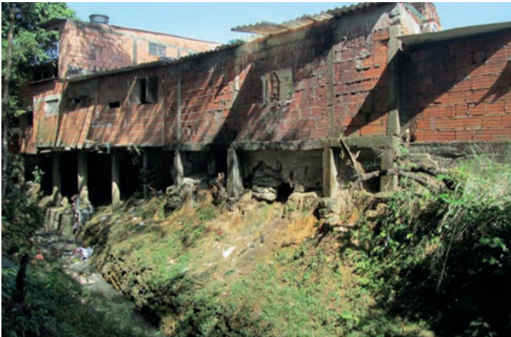
Figura 5: Tipos de vivienda. Viviendas invaden zonas de ronda de caños en superficies de inminente deslizamiento por erosión que causa la construcción misma y de las aguas propias del caño y lluvias, con inminentes consecuencias graves para sus pobladores. Esta fotografía muestra vivienda de estrato 1 en área de alto riesgo en el Barrio Estero Bajo sobre el caño la Cuerera.
