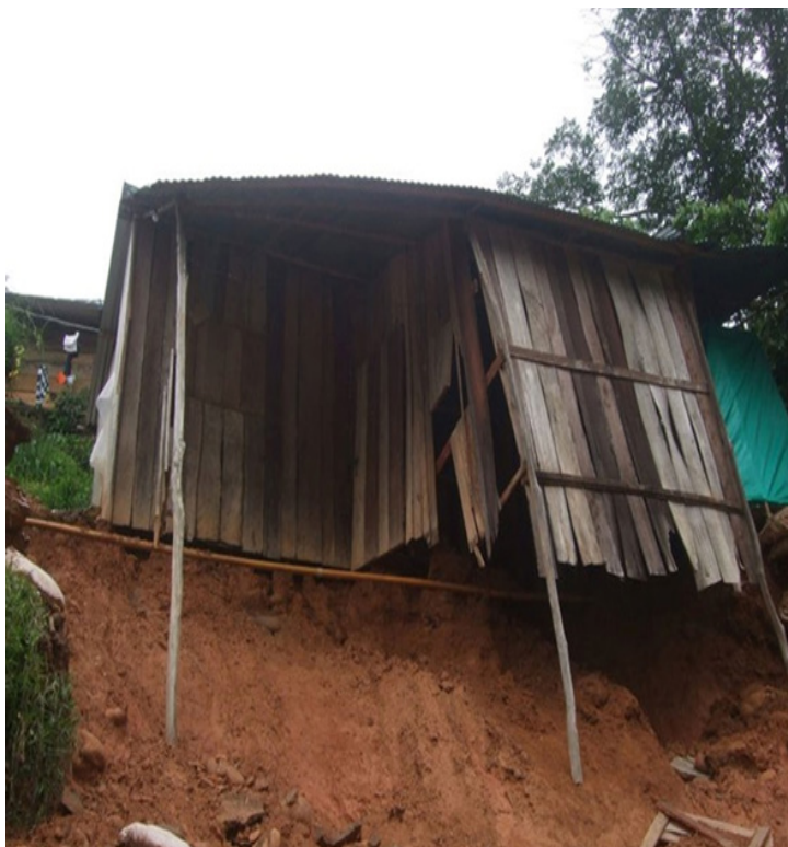
Figura 6. Aspecto de socavación por efecto de escorrentía bajo una casa en el asentamiento de La Nohora.
