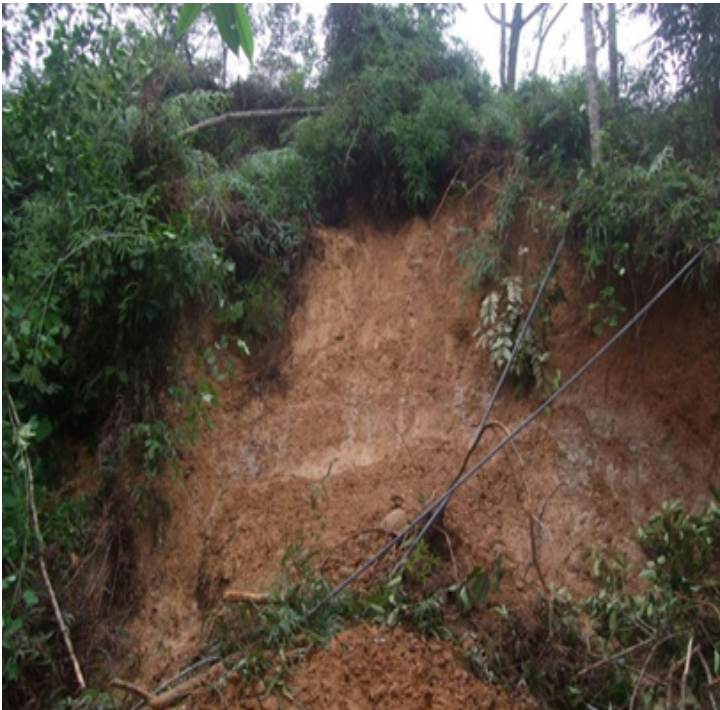
Figura 5. Aspecto de socavación por efecto de escorrentía en vecindades del Caño Fanagra.
