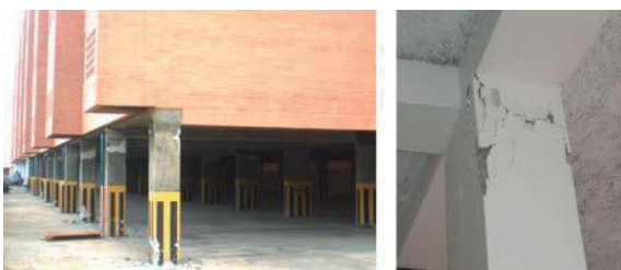
Figura 7: Entrepiso Blando típico debido a planta baja libre
