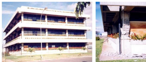
Figura 6. : Efecto de Columna Corta generado por muros de concreto armado
