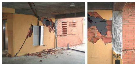
Figura 9: Efecto de Columna Corta inducido al fallar parcialmente la tabiquería
