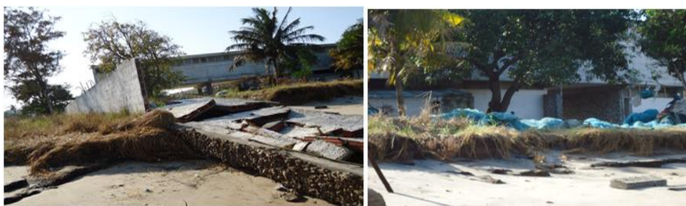
Figura 3. Destruição do muro de vedação do palácio dos casamentos da cidade da Beira na Ponta_Gêa
