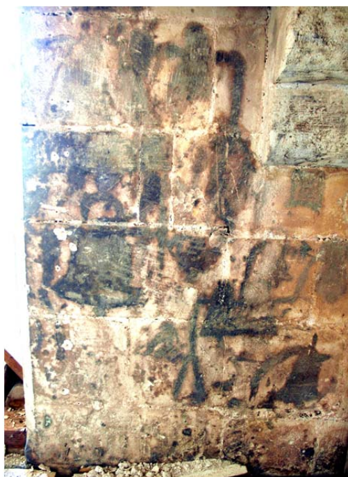
8. Dibujos de campanas. Niveles superiores del campanario de la Catedral de Mallorca. Pintadas en negro sobre el muro.
