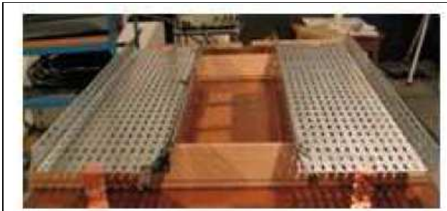
Figura 4: Cables en bandejas en lámina perforada paralelas
