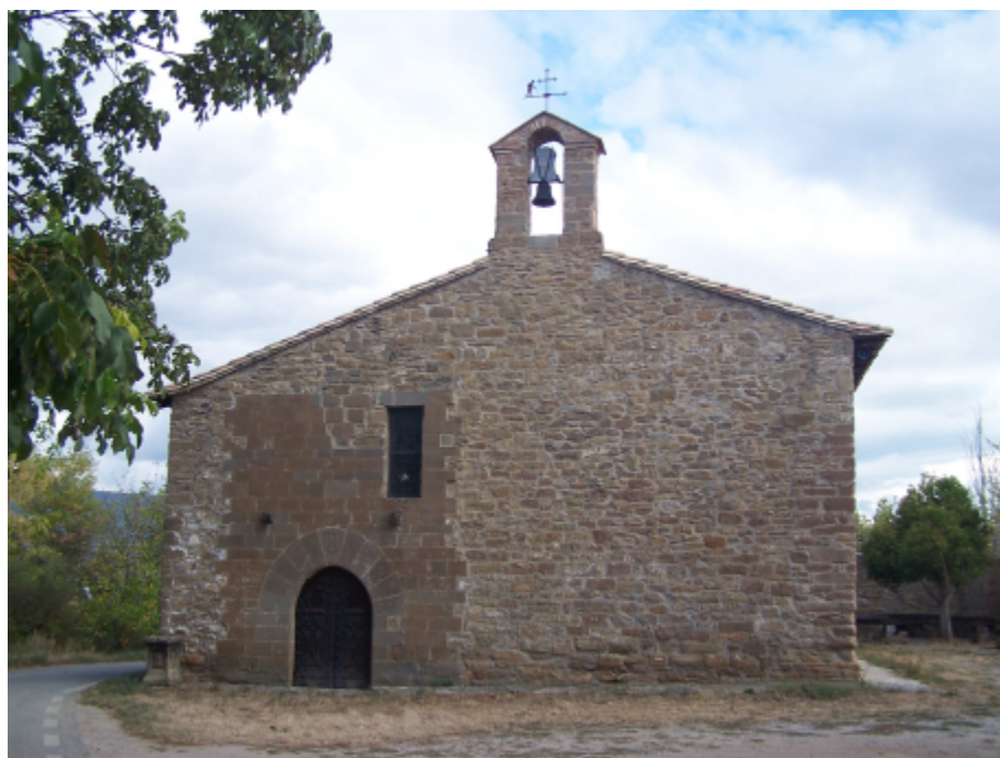
Fachada ermita de San Babil. Diferenciación de la sillería del XVI con la mampostería del resto de la pared, de rehabilitaciones posteriores. (Fotografía: D.M.O. Octubre 2013).
