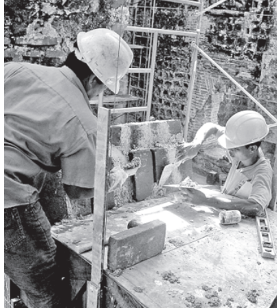
Figura 14. A la hora del encimbrado, la armadura se apuntaló debidamente a los muros y fue equipada con los accesorios necesarios para el descimbrado. (Foto: Patronato Panamá Viejo)
