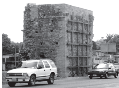
Figura 21. El Convento de San José después de los trabajos de consolidación. (Foto: Patronato Panamá Viejo)
