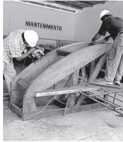
Figura 16. El descimbrado se ejecutó suavemente, sin golpes ni vibraciones que perjudicaran la obra realizada. (Foto: Patronato Panamá Viejo)
