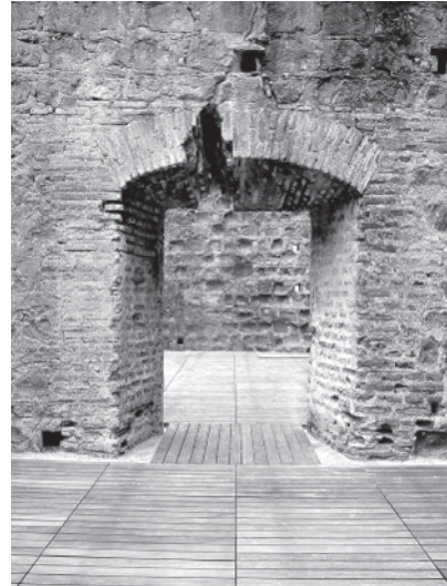
Figura 18. Vista de la capilla Sur del Convento de la Concepción. (Foto: Patronato Panamá Viejo)
