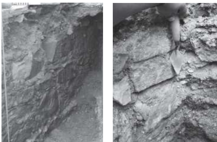
Figura 7. A la izquierda, detalle de la mampostería del lienzo de muralla encontrado en la CDR. A la derecha, detalle de la mampostería de la muralla documentada en la finca 1928.
