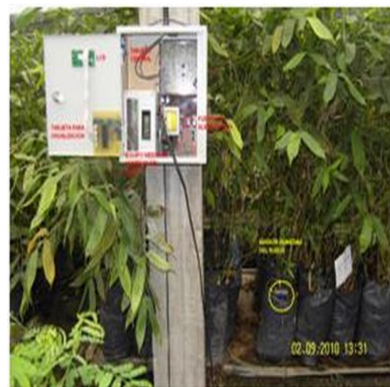
Figura 9. Caja central de adquisición de señales y medición de humedad del suelo.
