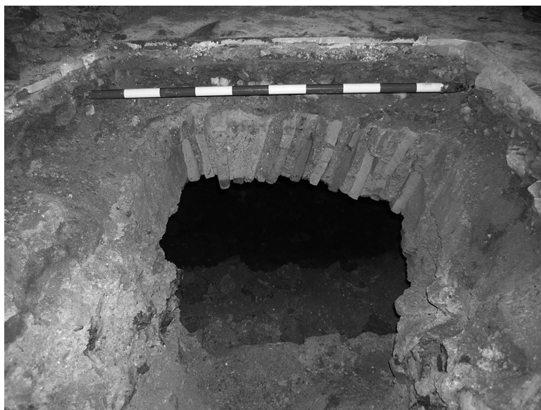
Fig. 12. Detalle del acceso a la Cripta II en que puede advertirse el relleno
