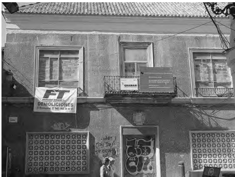
FIG. 8. Málaga, fachada del Palacio de Villalón en ruinas, sede del actual Museo Carmen Thyssen, 2006. Foto: Belén Calderón.
