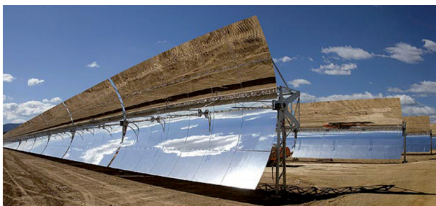
Figura 7. Colectores cilíndrico-parabólicos captadores de energía solar térmica de media temperatura.
