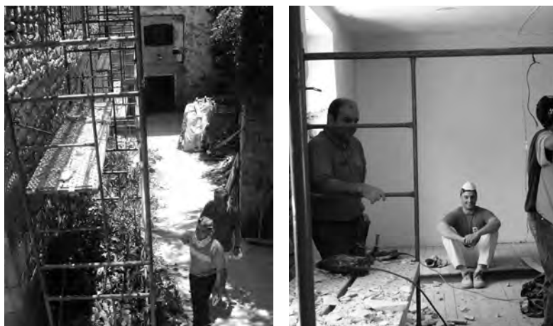
Trabajo en ozalan de los hombres de Muez para la rehabilitación de las antiguas escuelas del pueblo, actualmente sede de las reuniones del concejo de la localidad. 2009 y 2010. Pablo Orduna Portús.
