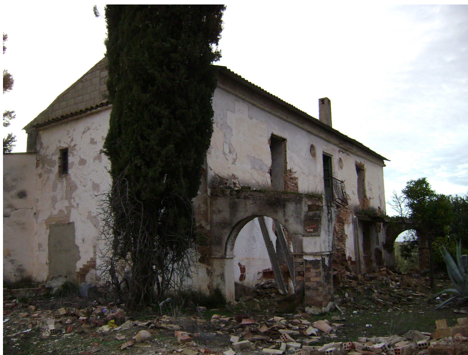
Estado actual de la Casa de Postas que fue escenario de la “Acción de Arjonilla.” Fuente Propia del Autor
