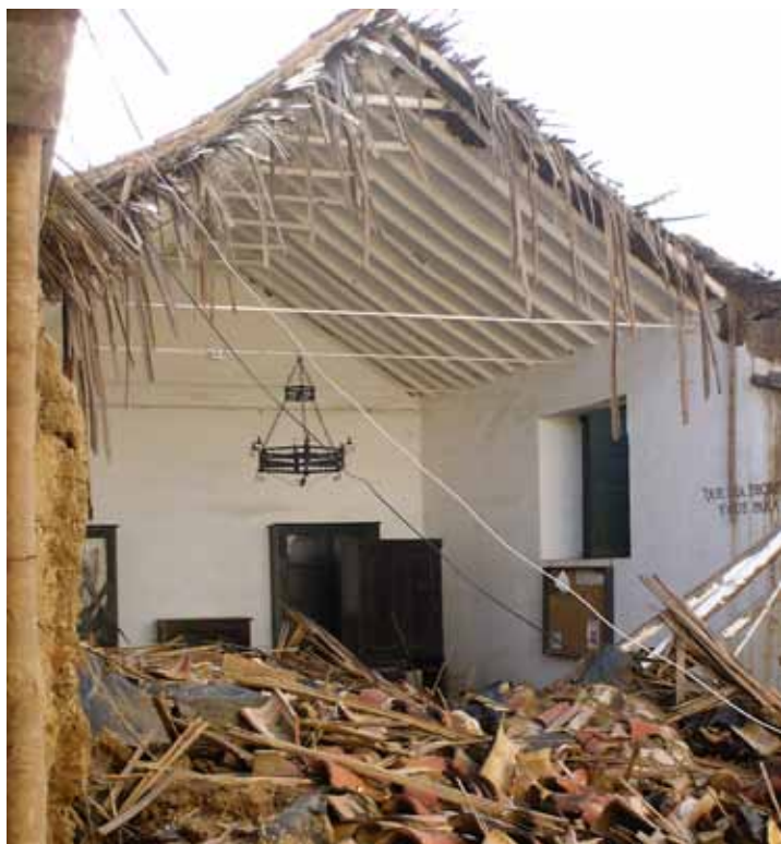
Museo Alberto Henríquez afectado por las lluvias del 2010
