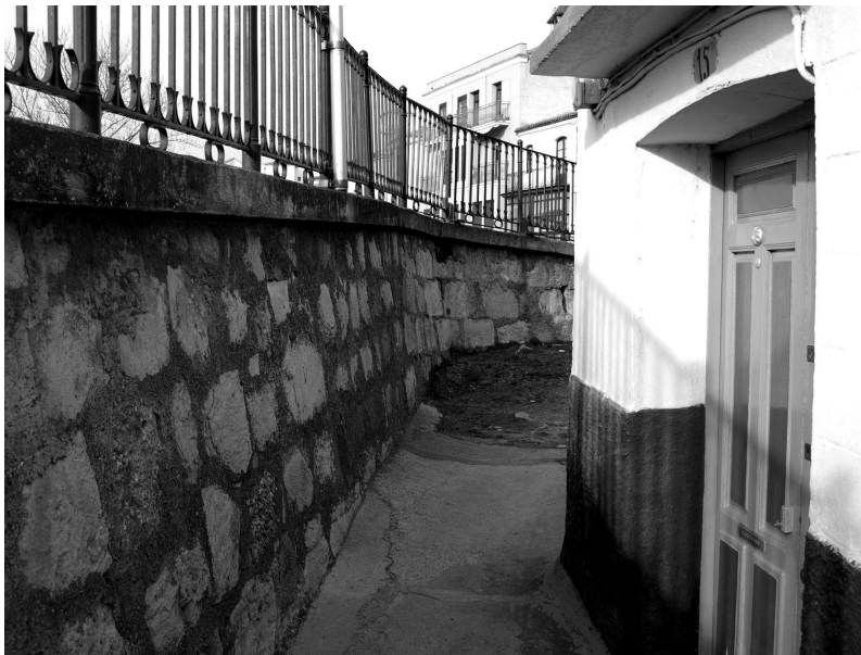
Figura 25: Rampas de acceso al puente. Estado actual.
