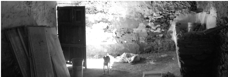
Estado actual de las cuadras de una vivienda para reformar en Alconchel (Badajoz). Fotografía del Autor.
