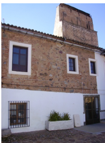
Fot. 11. Detalle del corral en el que se puede ver parte de la primitiva fachada norte de la casa-palacio y los esgrafiados de la chimenea.
