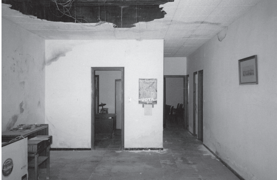
Fotos 11 a 13. Diverses imatges recents del local de la Cambra Agrària on es poden apreciar els desperfectes ocasionats per l'abandonament de les instal·lacions.
