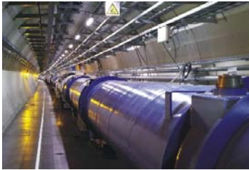
FIGURA 4. Dipolos en el túnel del LHC.
