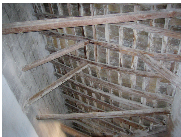
ESTADO DE CONSERVACIÓN DE LA ESTRUCTURA SOPORTE DE CUBIERTA DE LA PARTE ALTA DE LA IGLESIA —NAVE LATERAL IZQUIERDA CON DERECHO DE VUELO SOBRE PROPIEDAD VECINA—, A BASE DE ROLLIZOS SIN ESCUADRAR Y LADRILLOS POR TABLA, CON PRESENCIA DE ATAQUES DE XILÓFAGOS Y DEFORMACIONES IMPORTANTES POR FLECHA.
