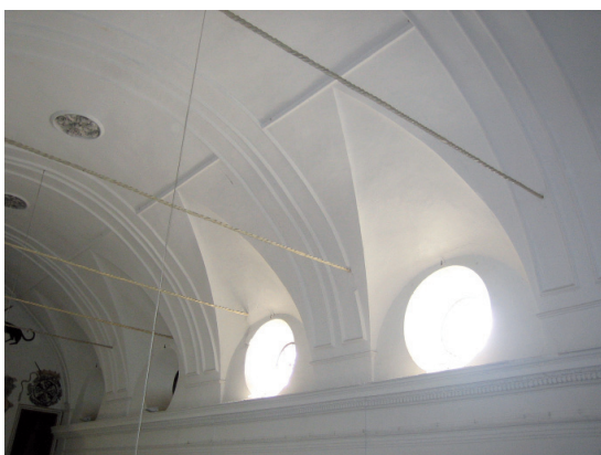
VISTA INTERIOR DE LA IGLESIA CON DETALLES DE LA BÓVEDA ENCAMONADA, LUNETOS DE ILUMINACIÓN Y TIRANTES DE HIERRO FORJADO QUE HAN PRODUCIDO ALTERACIONES EN LA BÓVEDA POR CEDIMIENTO DE ANCLAJE.
