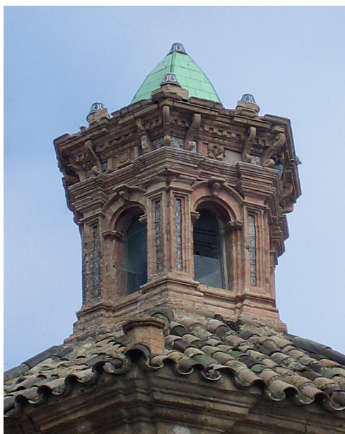
VISTA DE LA LINTERNA QUE CUBRE LA CAPILLA DE VIRGEN DEL ROSARIO, CON REMATES DE LADRILLOS APLANTILLADOS DETERIORADOS, DESAPARICIÓN DE LAS BOLSAS CERÁMICAS DECORATIVAS Y REVESTIDO DEL CHAPITEL CON MATERIAL INAPROPIADO. CRUZ Y VELETA DE PROBABLE EXISTENCIA, DESAPARECIDA.
