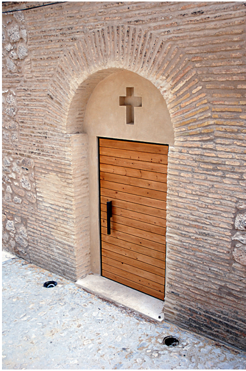
FIG. 7. LA PUERTA DE LA IGLESIA PRIMITIVA EN LA FACHADA. ESTADO TRAS LA OBRA.
