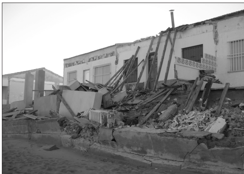
FIGURA 10. Concesiones administrativas sobre la Playa de Babilonia (Guardamar del Segura, Alicante), tras el temporal de 16 de enero de 2008. Varias de ellas fueron demolidas anticipadamente tras ser declaradas en ruina, aunque la concesión preveía su presencia hasta 2018. Foto: Francisco Torres.
