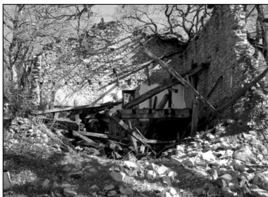
Fachada con los restos de pintura de las habitaciones
