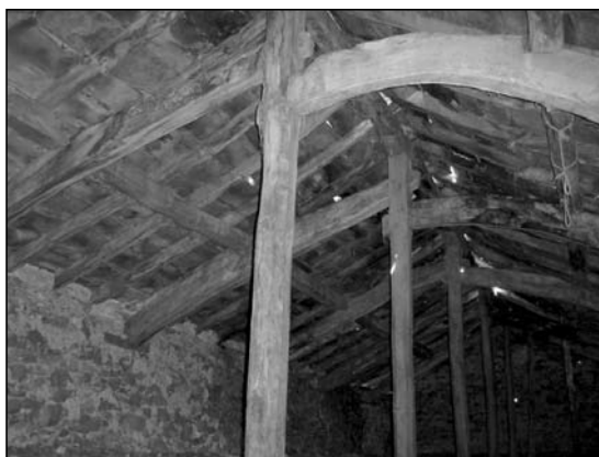
Estructura de la cubierta, interesante por la sistemática elección de vigas curvadas
