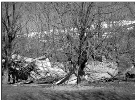
Las chapas de metal del tejado derruidas
