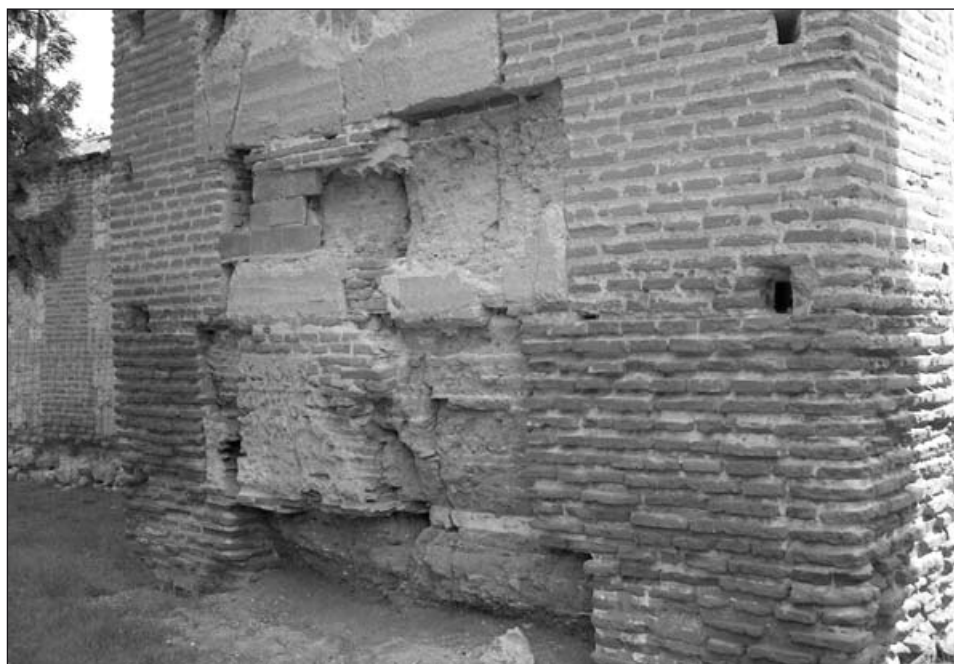
FIG. 9.—Detalle del estado actual de conservación de la muralla de Alcalá de Henares. Fotografía de Josué Llull.
