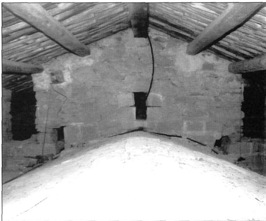
Fig. 45. Estat actual de la coberta amb les restes del primitiu enteixinat, damunt de les voltes de guix, que caldria reconstruir
