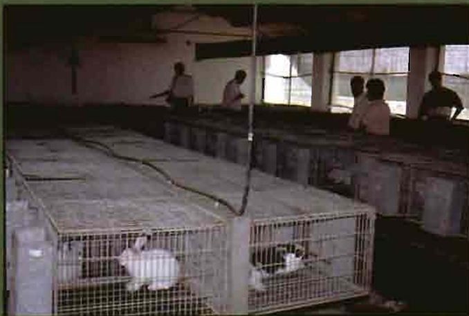
Figura 9: El aire frío se reparte por toda la nave a través de tubos adaptados al techo de la nave (detalle fecha).
