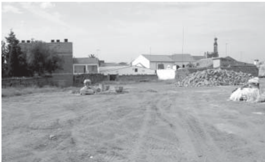
Vista parcial del solar destinado a la construcción del edificio de nueva planta, una vez finalizada la demolición
