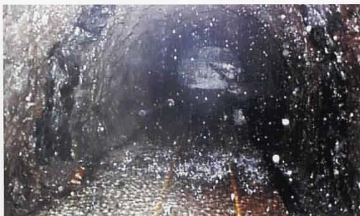
Final de la galería de fondo del pozo "Los Padrones" (valle de El Golfo, El Hierro). Tramo perforado dentro del acuífero, donde las aportaciones surgen del fondo, hastiales y techo.
