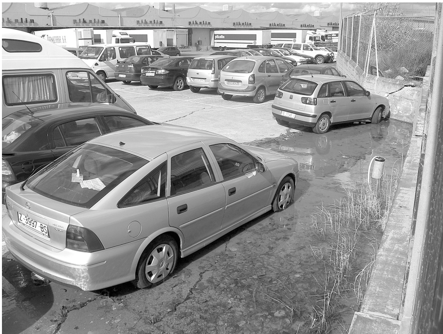
Figura 3. Presencia de fracturas en el suelo y las paredes del parking de una fábrica al oeste de la ciudad de Zaragoza. Fotografía realizada por Andreas Deckelman y Christian Tigler. Febrero 2006.
