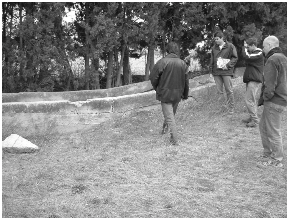
Figura 4. Ruptura en un pequeño canal en las proximidades de La Cartuja debido a la subsidencia del terreno. Marzo 2006.
