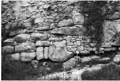
Lámina 27. Gerunda : muralla de Les Àligues, en el sector Sudeste de la ciudad romana. Obsérvese el zócalo poligonal de la II manera de época fundacional, con reparaciones de mampostería, sobre el que se creció en época medieval un alzado de esta misma técnica que sustituyó a las fábricas romanas. La cronología de este zócalo se localiza en el segundo cuarto del siglo I a.e.
