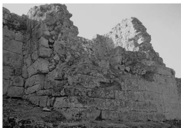
Lámina 31. Olèrdola: "Torre I", de opus quadratum irregular de la muralla de la fortaleza. La cronología de esta obra se localiza entre finales del siglo II y comienzos del I a.e.
