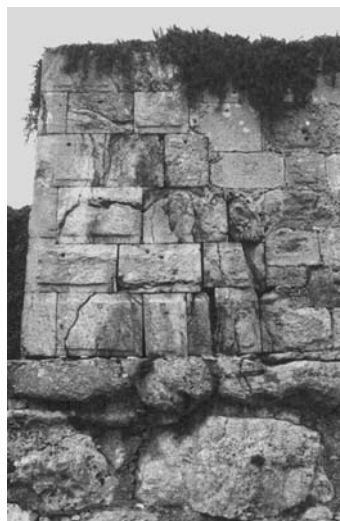
Lámina 56. Tarraco : detalle de esquina Nordeste de la Torre de Minerva/Sant Magí, perteneciente a la primera fase de la muralla de la ciudad, datada en torno al 200 a.e. Obsérvese el aparejo poligonal de la II manera del zócalo, sobre el que por medio de pequeñas cuñas se asentó el alzado de opus quadratum , sólo conservado en este caso en la parte a la izquierda de la imagen. Obsérvese los sillares, con la cara externa de tendencia cuadrada provistos de almohadillado alisado enmarcado por listel perimetral de notable anchura, con engatillamientos y orificios tallados para ser elevados por medio de ferrei forfices , tapados posteriormente con unas pequeñas plaquitas de piedra.
