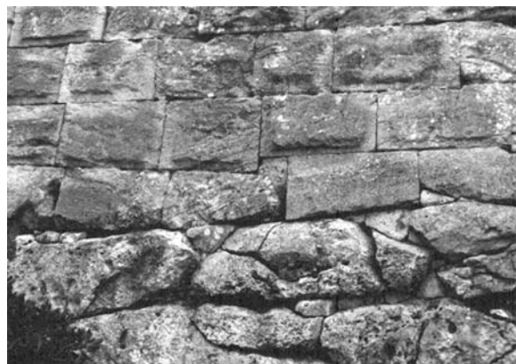
Lámina 60. Tarraco : detalle de uno de los métodos de transición empleados para asentar el alzado de opus quadratum sobre el zócalo poligonal de la II manera en la segunda fase de la muralla de la ciudad, datable en el tercer/último cuarto del siglo II a.e. Este pequeño tramo se localiza en la cortina delimitada por las torres del Arcebisbe y Cabiscol. Obsérvese que en este caso se tallaron los bloques de la primera hilada de sillares de quadratum con formas poligonales, que se asemejan a las de los bloques poligonales del IV manera, con objeto de adaptarse a las irregularidades de los bloques poligonales del zócalo.
